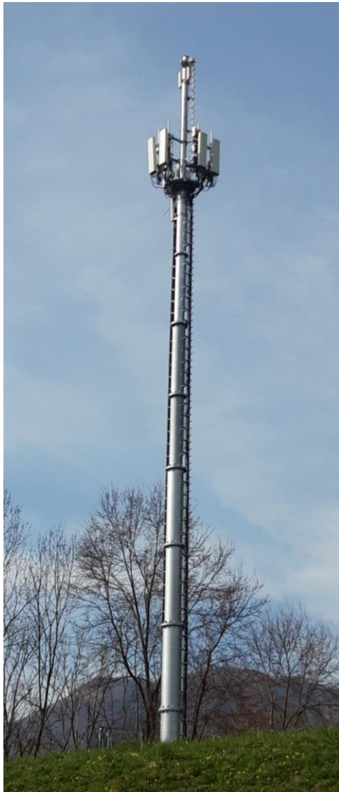
Figura 1: Impianti di Via degli Alpini - Albino (BG)
